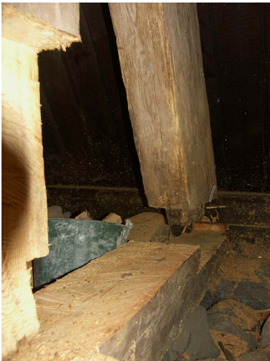
Synlig tapp i snedsträva efter renhuggning, punkt A
