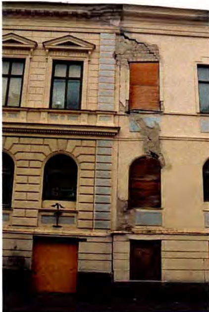
Den kraftigaste sprickan finns i skarven mellan tillbyggnaden och den ursprungliga byggnaden.
