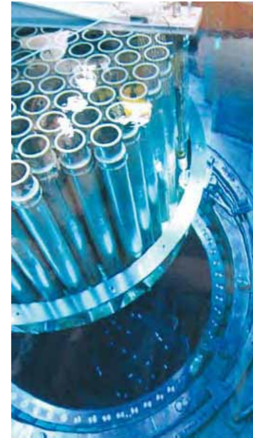
Reaktorns interndelar byttes under revisionen. Ny fuktavskiljare och nytt moderatortanklock installerades. Bilden visar ångseparatorerna på moderatortanklocket som sätts på plats i reaktorn. Foto: Nikolas Forsberg.
