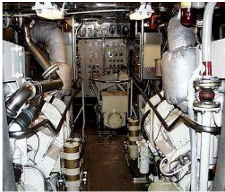
Maskinrummet, sett förifrån
