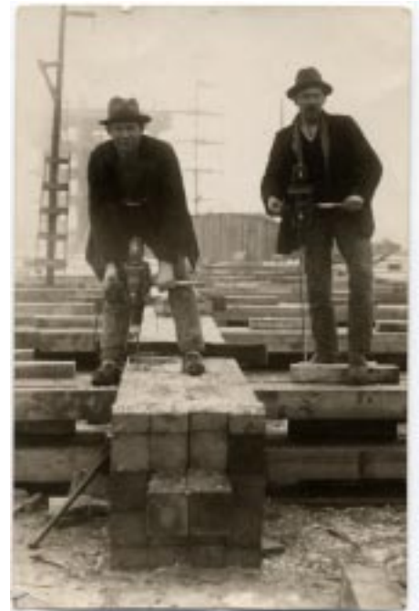
Bröderna Oscar och Ivar Carlsson borrar hål för bultsystemet på en pelare till lagerhuset. Foto från VLEF.
