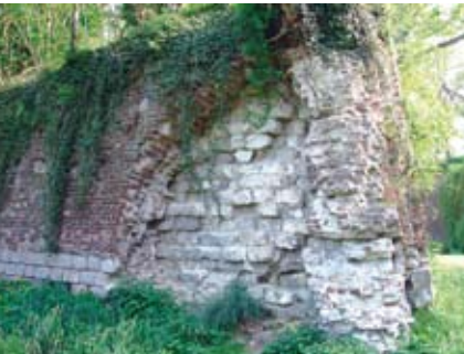
Détail de la constitution du mur de la contre-garde du Roy (avant restauration) © Service Ville d'art et d'histoire, Ville de Lille
