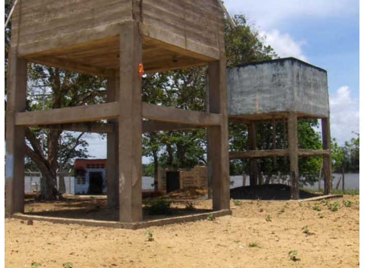
Foto 6. Tanque de agua abandonado sin terminar en Pueblo Blanco
