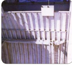
홍수 방지 수문 (FLOOD CONTROL GATES)
