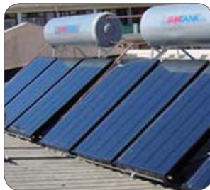
EN 1.4509/441 (실린더), Sun tank and SASSDA, 남아프리카공화국
