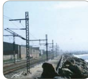
전화 마스크 (ELECTRIFICATION MASTS)
