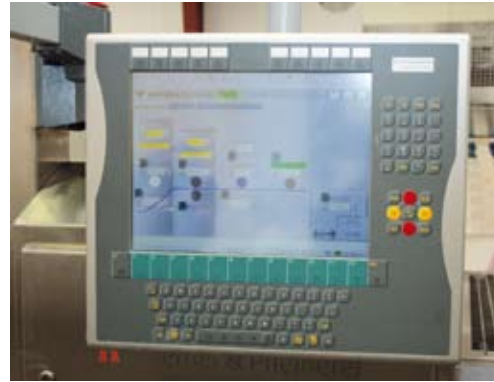
Übersichtlich: Auf einem großen Display lässt sich die Anlage abbilden.
