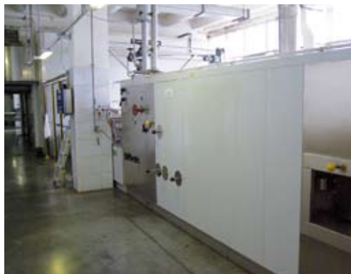
Die Öfen sind Heizgasumwälzer mit getrennt regelbarer Ober- und Unterhitze. Sie mussten exakt in die bestehenden Räume integriert werden.
