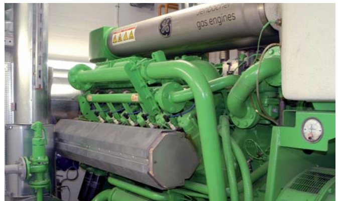
Biogaserzeugungsanlage (Bild links) Erzeugung von Strom und Wärme im BMHKW (Bild unten)
