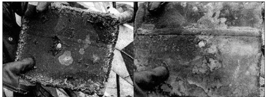
Rys. 3. Efekt wpływu prądów błądzących na ściankę rurociągu ciepłowniczego
