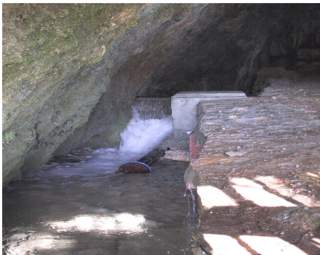
Fig. 5. Captación de aguas en la cueva de La Toba. El registro y tubo negro que aparece sellado, ha sido instalado hace pocos meses (4 ó 5), sin autorización del Organismo de Cuenca (C.H.D), con el objeto de abastecer la nueva urbanización. Ver la otra captación realizada ( Fig.7).
