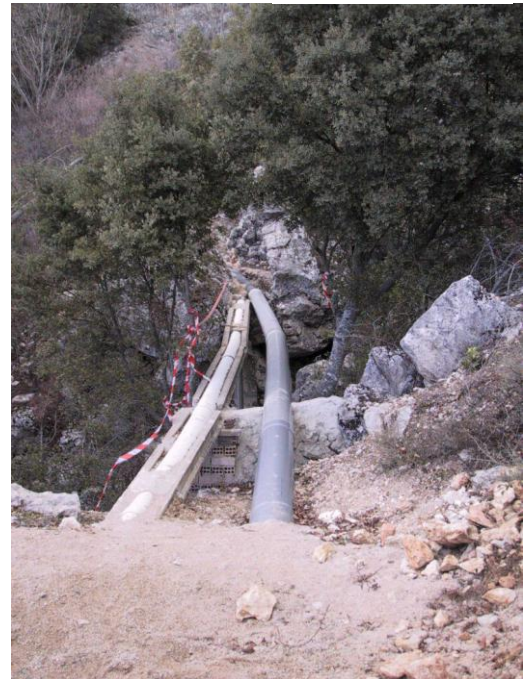
Fig.6. Obras presuntamente ilegales de conducción de aguas en la zona superior a la cascada de La Toba, realizadas recientemente (4 ó 5 meses).
