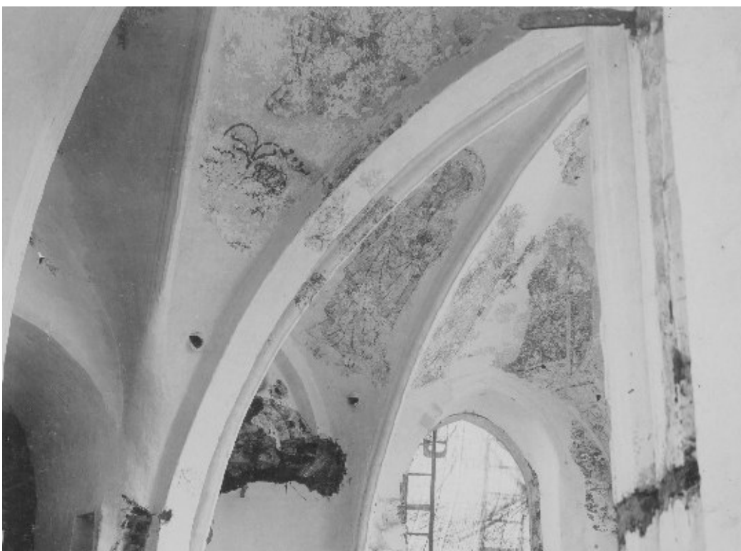
Abb. 40: Isernhagen-Kirchhorst, ev. Kirche St. Nikolai, Chorgewölbe, Zustand nach der Freilegung 1899 mit Putzergänzungen. Foto 1899.
