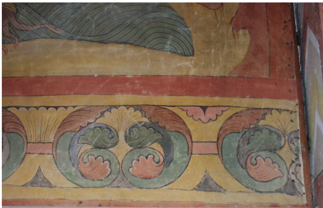
Abb. 20: Braunschweig-Melverode, ev. Kirche St. Nikolai, Chornordwand, Leinwandbespannung mit Kopie der Wandmalerei, rechts im Bild Nägel zur Befestigung.
