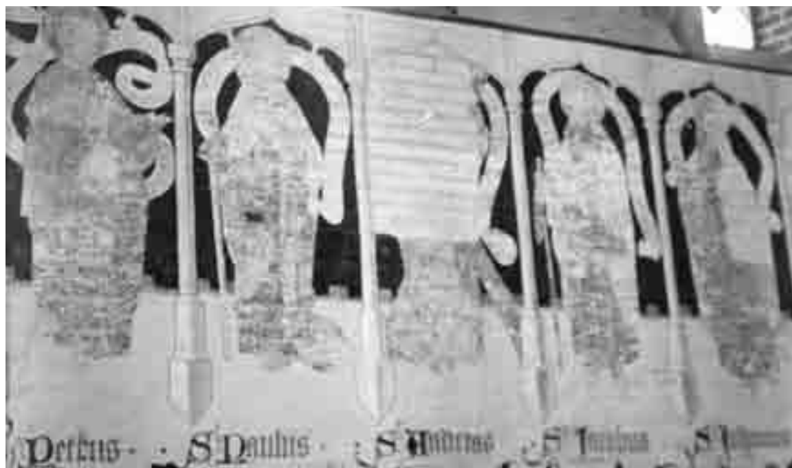
Abb. 45: Neustadt-Mandelsoh, Ev. Kirche St. Osdacus, Chornordwand, nach der Freilegung 1907/08, Fehlstelle in der Figur des Andreas durch Fensterzumauerung.
