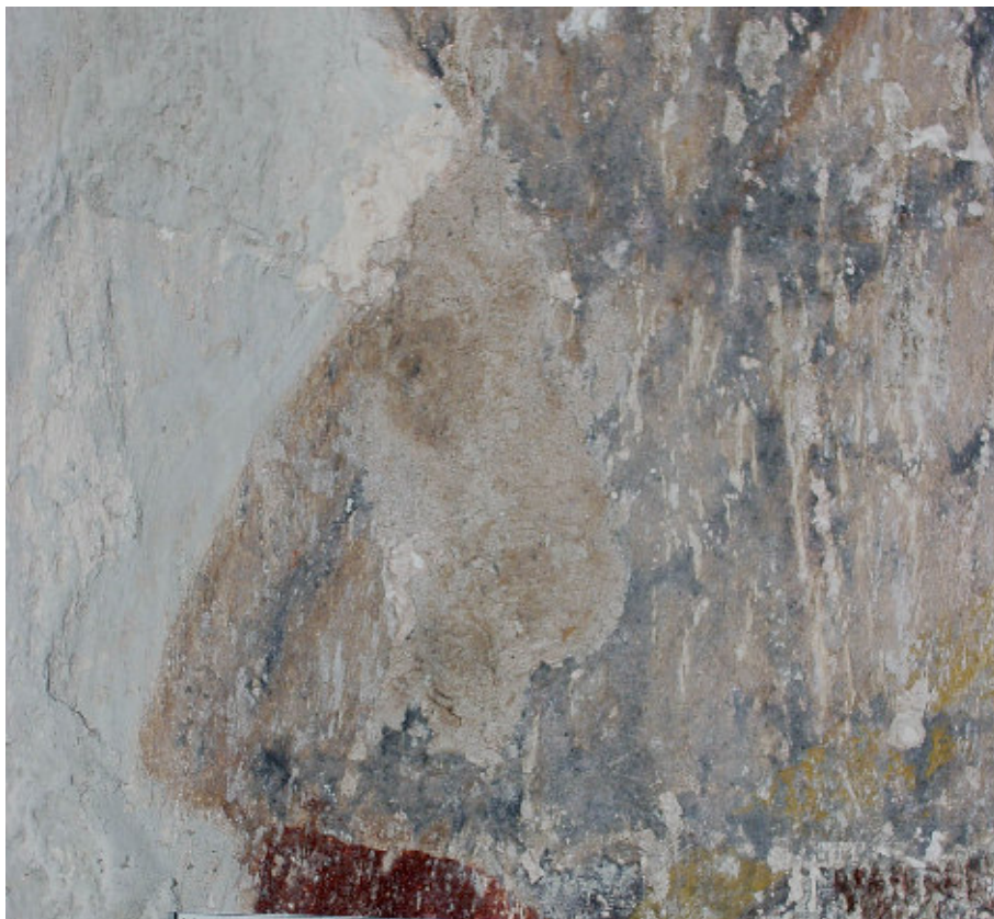
Abb. 75: Hannoversch Münden –Lippoldshausen, ev. Kirche St. Petri, Chorturm, Nordwand. Mittelalterlicher Malereibestand mit grau-braun eingetönter Fehlstelle durch Bucker 1911. Foto 2005.
