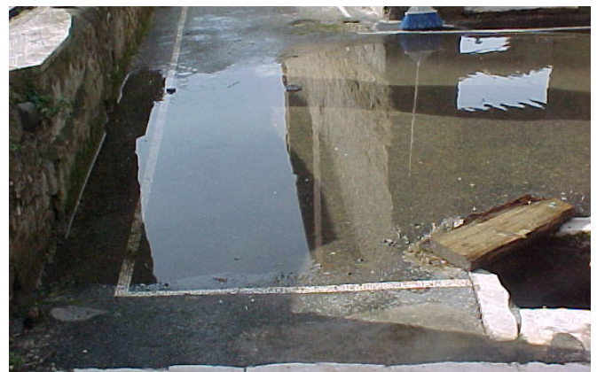
Un esempio della presenza di acqua sul sito, dove il sistema di scolo delle acque è danneggiato. La bocca di cisterna in basso a destra della foto, non smaltisce l'acqua adeguatamente a causa di cambiamenti nell'inclinazione dei pavimenti.
