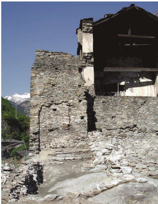
9. Veduta da est del vano scalare con la scala di accesso antistante. (S.E. Zanelli)
