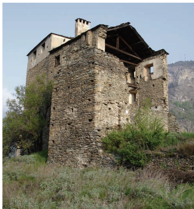
3. In primo piano la torre scalare addossata alle strutture del castello prima dell'avvio dei lavori. (M. Cortelazzo)
