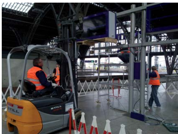
Menschenleere Bahnsteige - nur die Bauarbeiter sind vor Ort und installieren die neuen Fahrgastinformationsanzeiger auf den Bahnsteigen; Foto DB AG.
