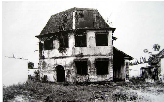
Fig. 17. Yogyakarta, fort Vredenburg, bâtiment des officiers, état avant la restauration (photo de Temminck Groll, TG KL 17-8, Rijksdienst voor de Monumentenzorg).
