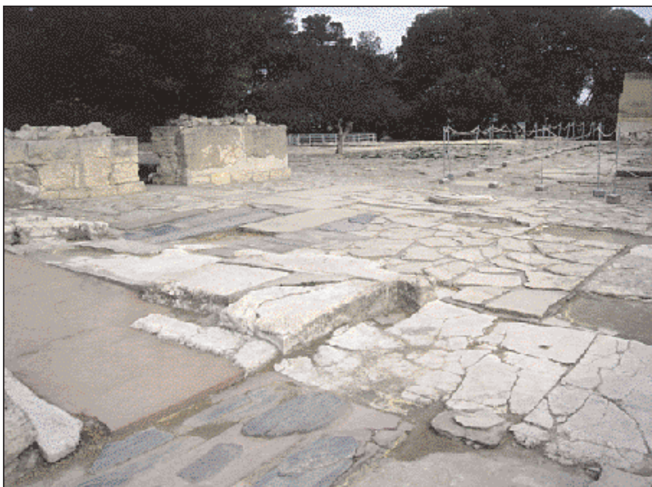
Τμήμα της δυτικής αυλής και του «διαδρόμου πομπής», με φθορές στα δάπεδα.
