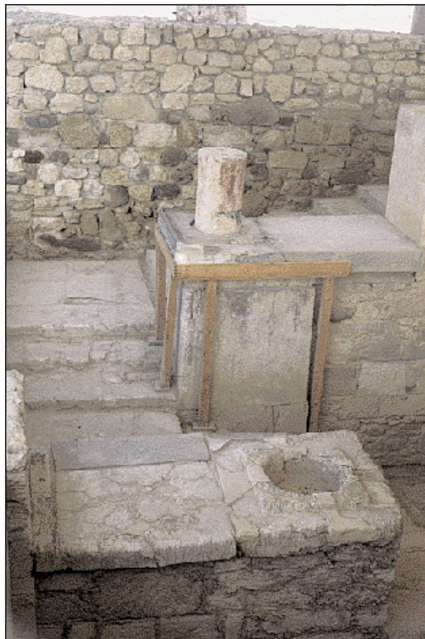
Το μεγάλο κλιμακοστάσιο, η κατάσταση του οποίου, σ' όλες τις επιφάνειες, θεωρείται και είναι τραγική, λόγω των φθορών που έχει υποστεί είτε από τις επισκέψεις τουριστών είτε από τις φυσικές συνθήκες.
