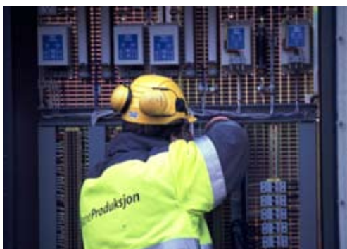
Sikringsanlegg. Foto: Rune Fossum
