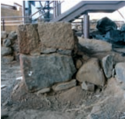
■ Foto 8. Problemas de alteraciones en un muro.
