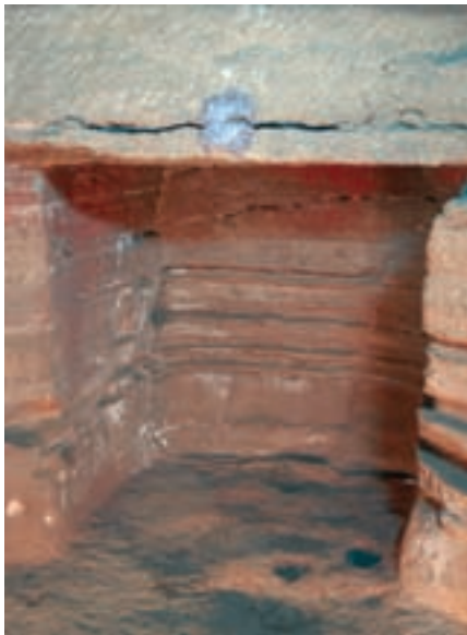
■ Foto 6. Detalle de la fisura de una de las cuevas anexas; en el centro se observa un testigo de cemento colocado el año 1980.
