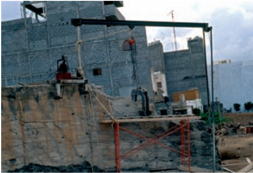
■ Foto 20. Demolición del muro de hormigón construido a raíz del vaciado de 1970 en torno a la Cueva Pintada.
