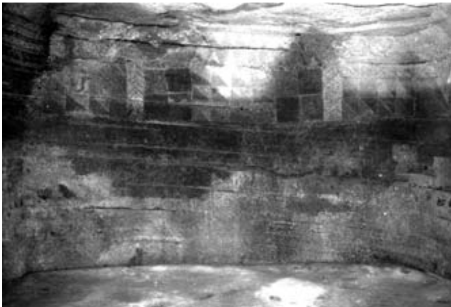
■ Foto 15. Estado del interior de la cámara decorada tras la apertura al público, se aprecian las enormes manchas de humedad en las paredes de toba.
