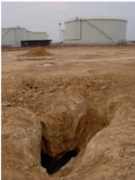
■ Foto 1. Cata efectuada en el futuro emplazamiento de un depósito de combustible, descubriendo la oquedad determinada por la prospección con georradar, mostrada en la figura 3.
