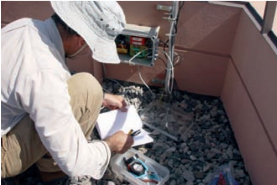
■ Foto 5. Detalle de la instalación y conexión de los distintos sistemas de registro.
