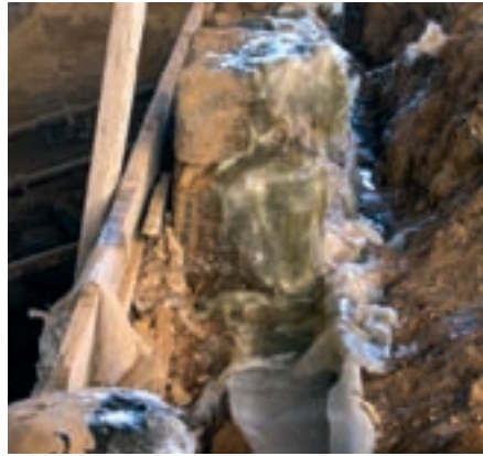
■ Foto 24. Reforzamiento posterior de un muro con poliéster y fibra de vidrio.
