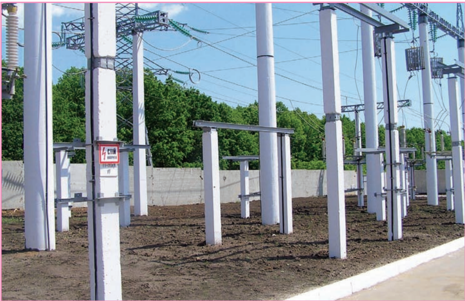
Підстанція «Перемога» підвищила надійність енергозабезпечення Олексіївки та у майбутньому дасть змогу забезпечити пуск нових станцій третьої лінії Харківського метрополітену
