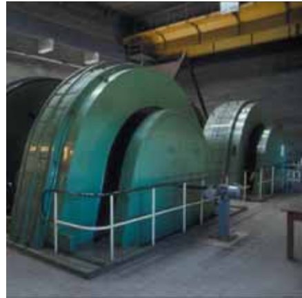
Fördermaschine im Förderturm
