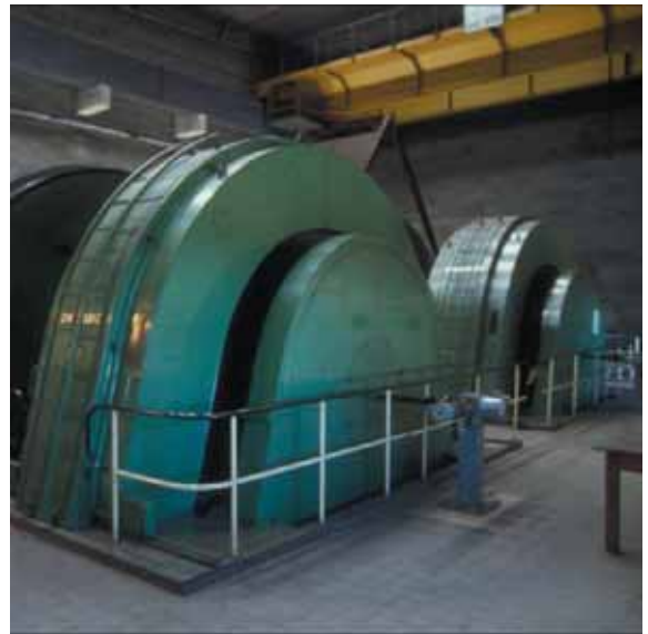
Fördermaschine im Fördererturm
