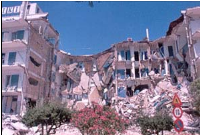
Φωτογραφία από την πτέρυγα του ξενοδοχείου «Ελίκη» που κατέρρευσε
