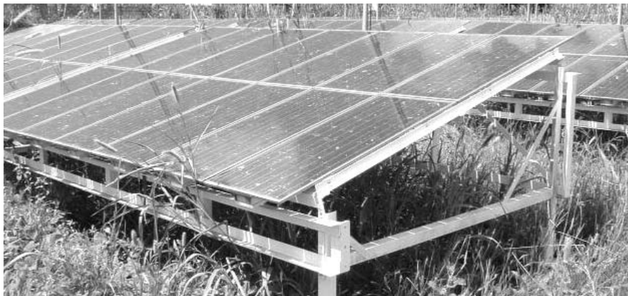
Installation solaire photovoltaïque pour le pompage de l'eau, Sénégal
