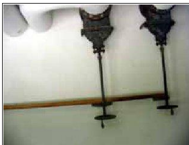
Рис. 10. Тяжёлые трубы с двойными стенками для горячей воды (или пара?) в помещении за предполагаемой газовой камерой Дахау, ведущие в пространство над нынешним помещением[121].
