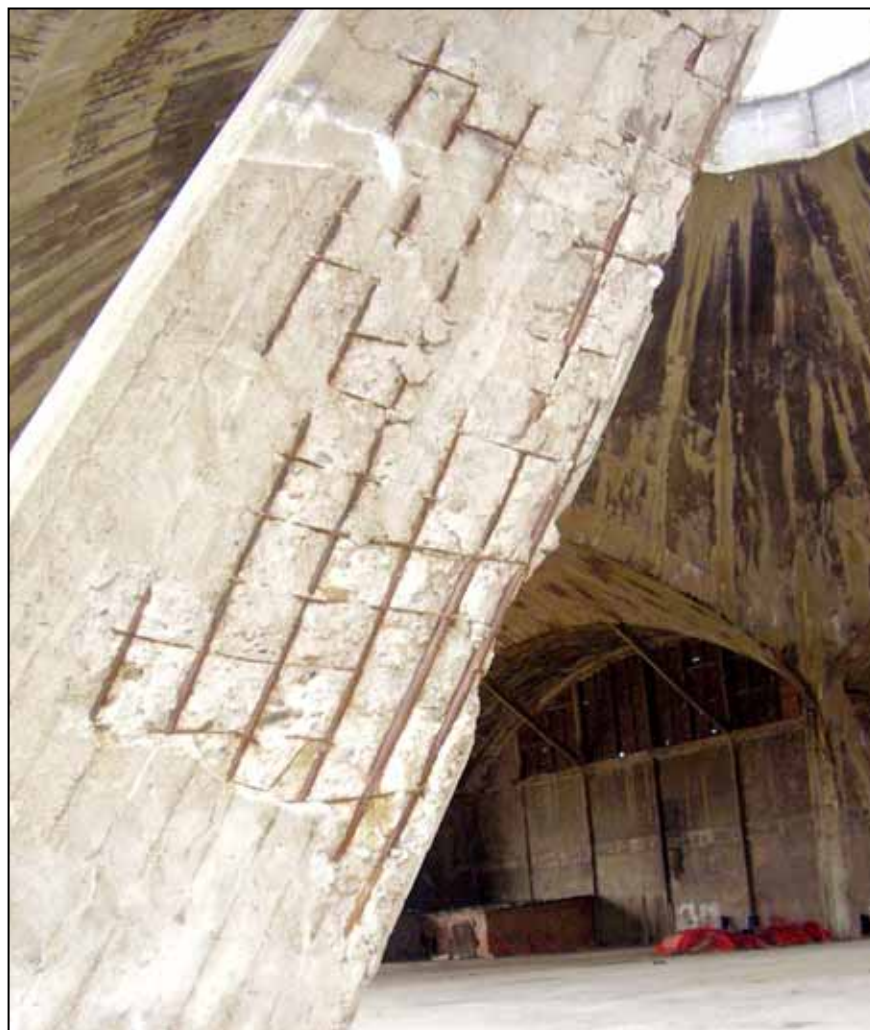
AASTAKÜMNEID ON ILMASTIK PURENUD ANGAARIDE RAUDBETOONKONSTRUKTSIOONE. AMPSUD ON JÄTNUD SELGELT NÄHTAVAD JA OHTLIKKE JÄLGI
