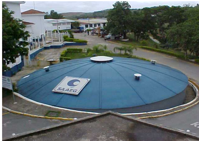
Reservatório (R1) de 1200 m 3 – poço de sucção da EAT - ETA
