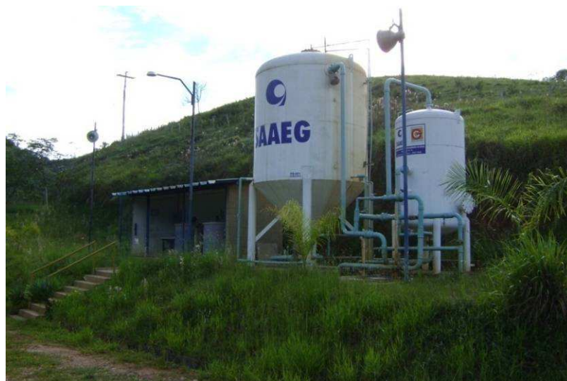
Estação de tratamento de água - Rocinha
