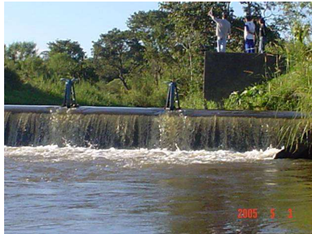
Captação de água bruta do Ribeirão Guaratinguetá
