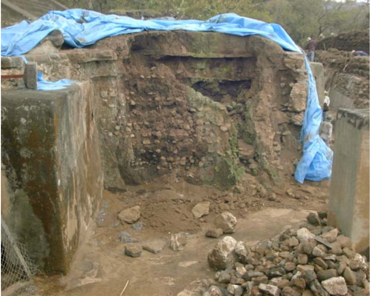
Figura 13 Colapso del Edificio de las Columnas en 2006
