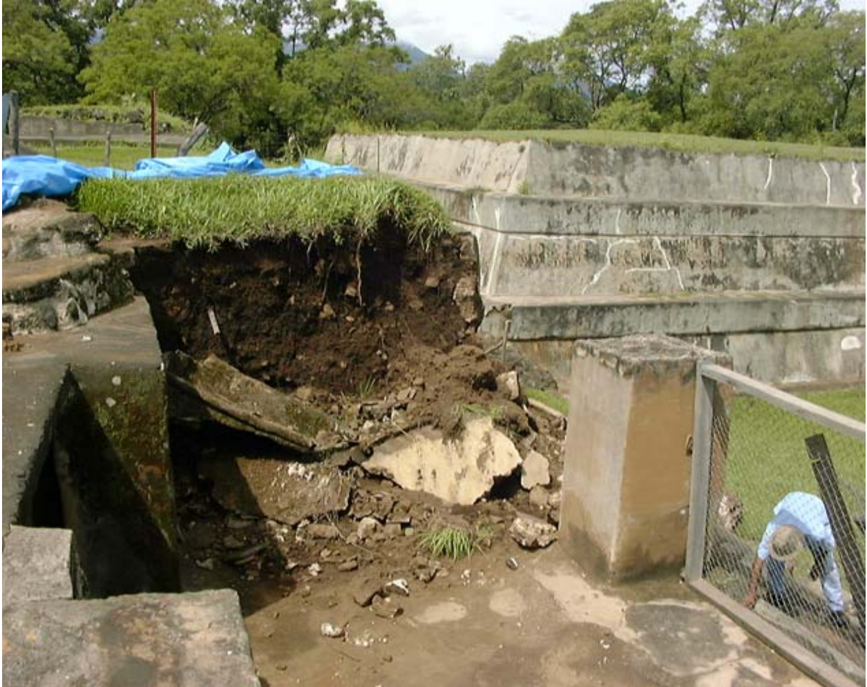
Figura 12 Colapso del Edificio de las Columnas en 2002
