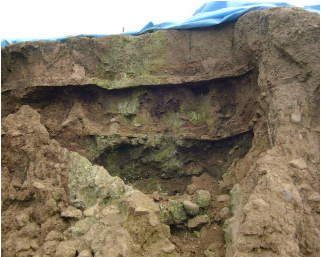
Figura 14 Colapso del Edificio de las Columnas en 2006
