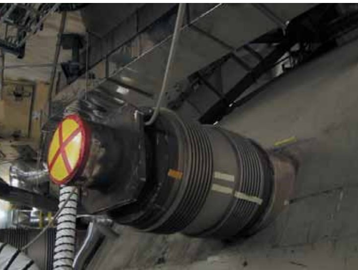
geschnittene Dampfleitung am Sicherheitsbehälter
