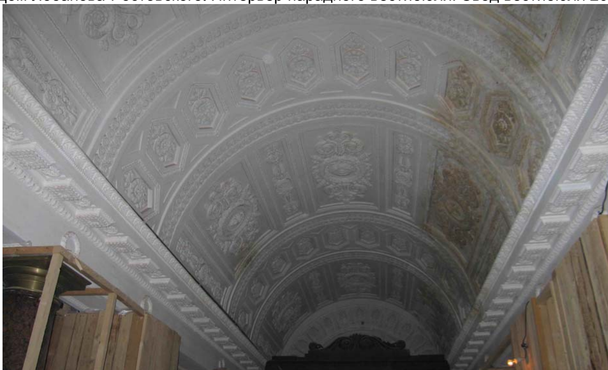
22. Дом Лобанова-Ростовского. Свод вестибюля. Повреждение лепного декора в результате переувлажнения: потеки ржавчины, возможно развитие плесени на поверхности. Апрель 2009 г.
