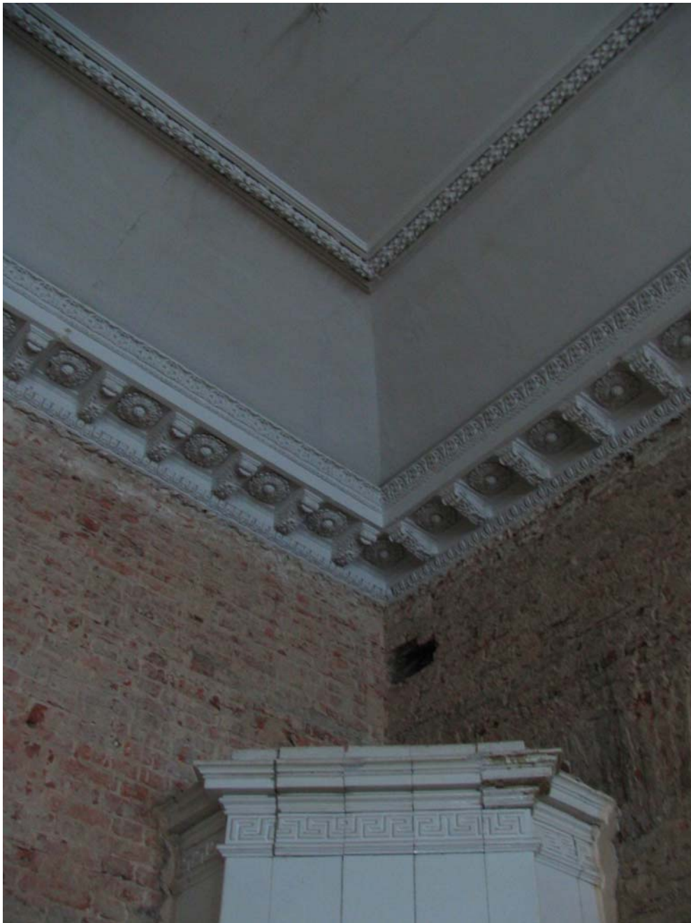
8. Дом Лобанова-Ростовского. Интерьер зала большой анфилады к западу от Центрального зала (помещение 5). Карниз по периметру помещения из модульонов, декорированных акантовым листом, и розеток между ними. Печь угловая, облицована белыми гладкими глазурованными изразцами. Фриз – полоса рельефных изразцов с меандром. 2005 г
