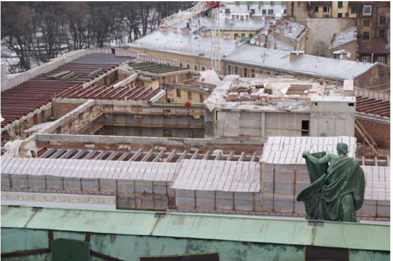
43. Работы по разборке кровли без устройства защитного укрытия. Март 2009-г. (Привели к повреждению внутренних конструкций и декоративных элементов)
