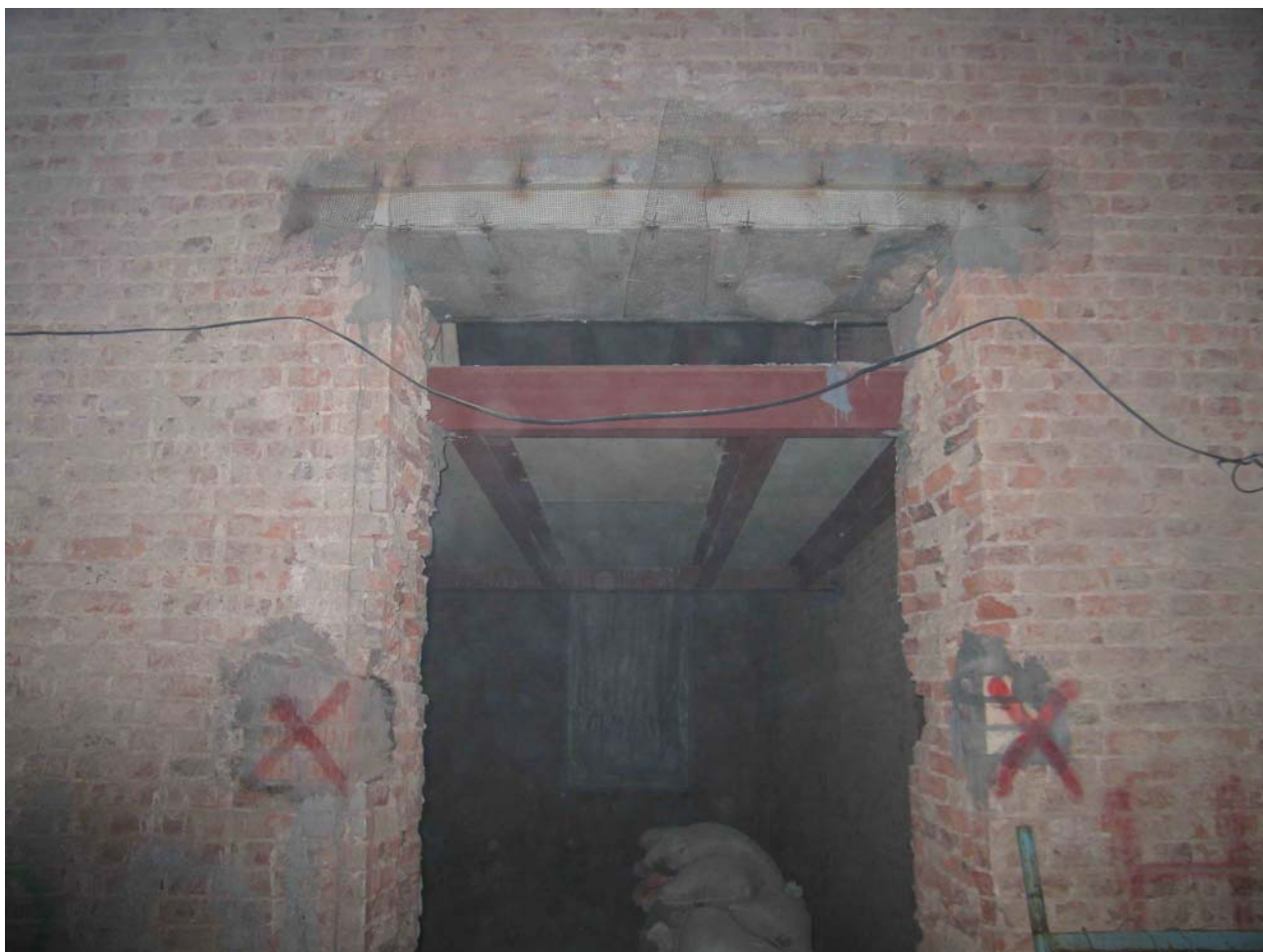
17. Дом Лобанова-Ростовского. Устройство новых перекрытий с нарушением объемно-пространственной структуры помещений. Апрель 2009 г.
