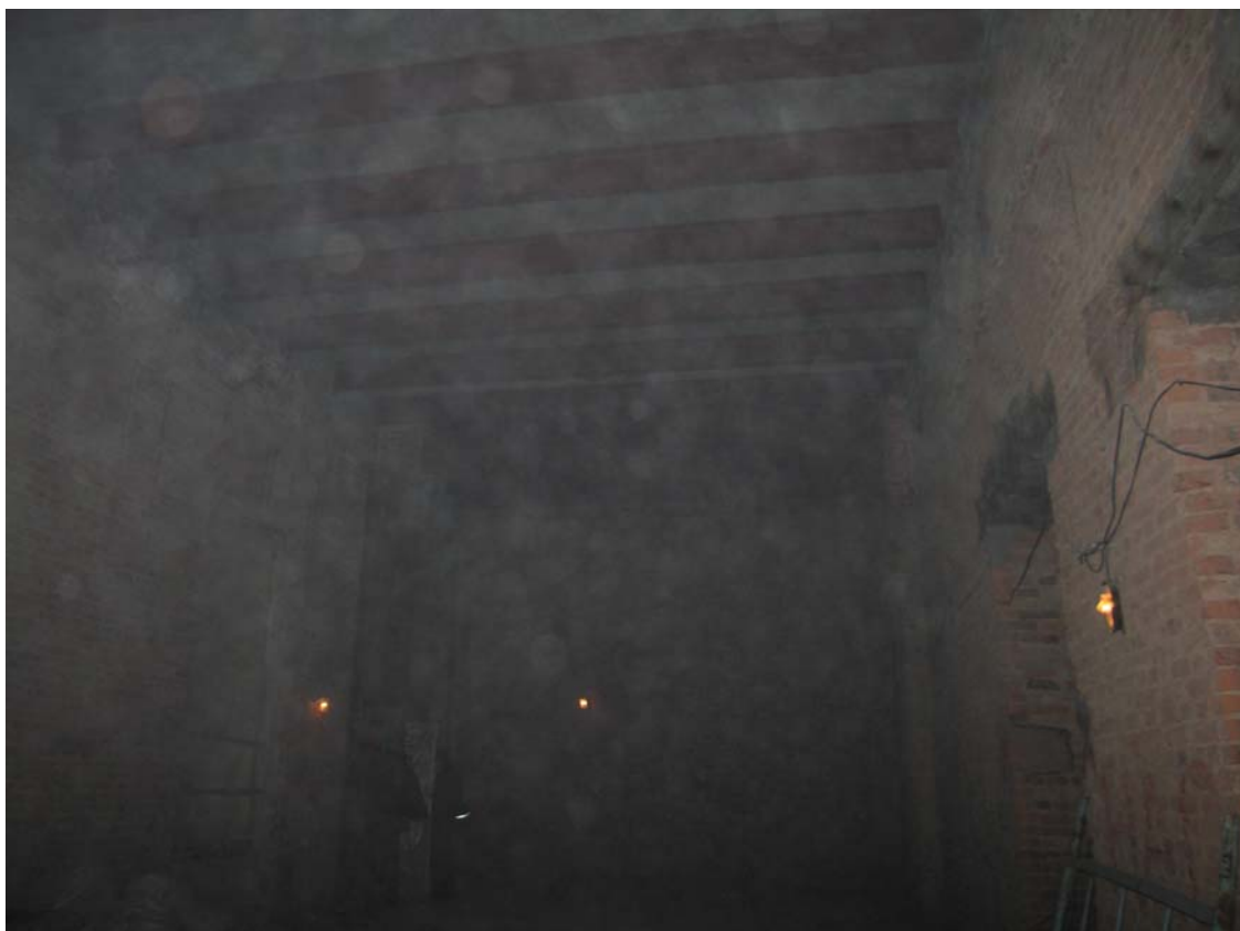
19. Дом Лобанова-Ростовского. Устройство новых перекрытий. Полное удаление штукатурки со стен и потолков. Апрель 2009 г.
