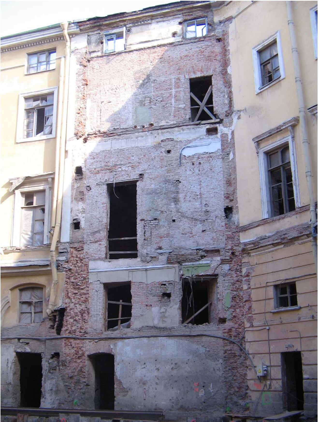
30. Дом Лобанова-Ростовского Дворовый фасад после сноса флигеля А-4. Сентябрь 2007 г.
