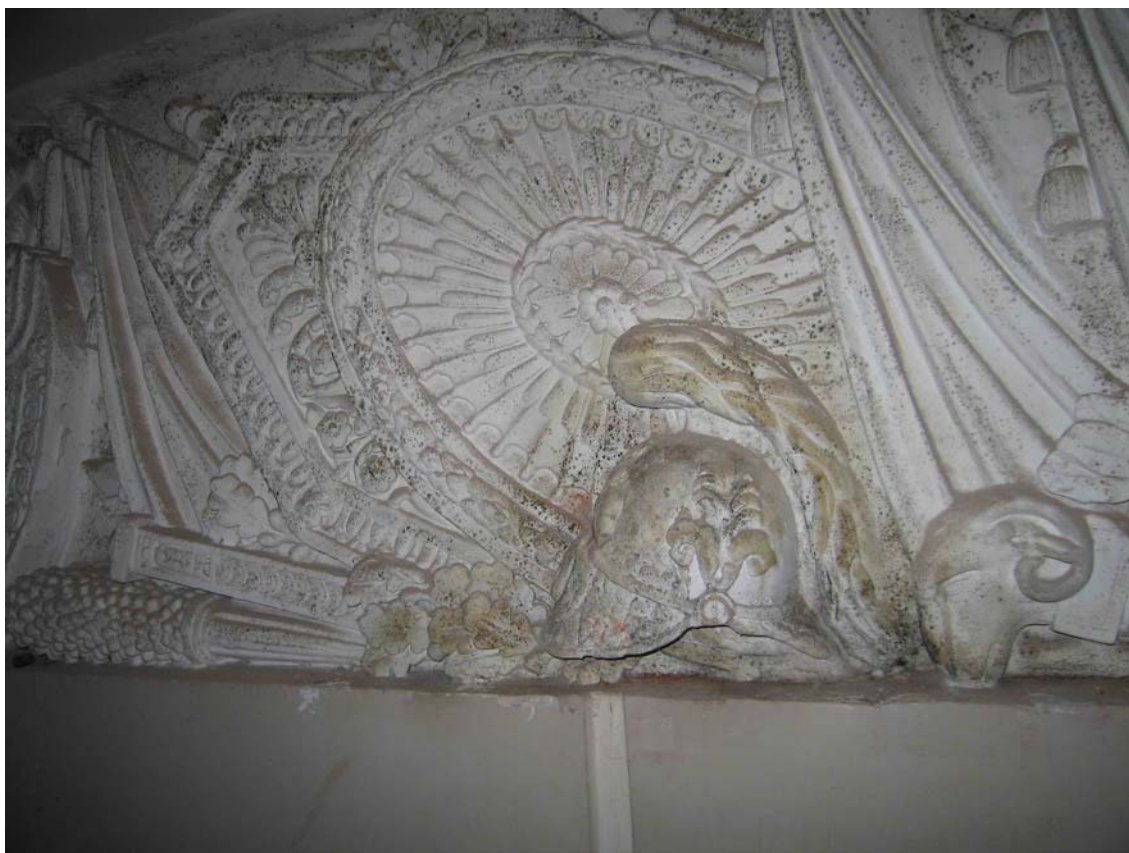
27. Дом Лобанова-Ростовского.Барельеф парадной лестницы. Повреждение лепного декора в результате переувлажнения: биогенные загрязнения, потеки ржавчины. Апрель 2009 г.
