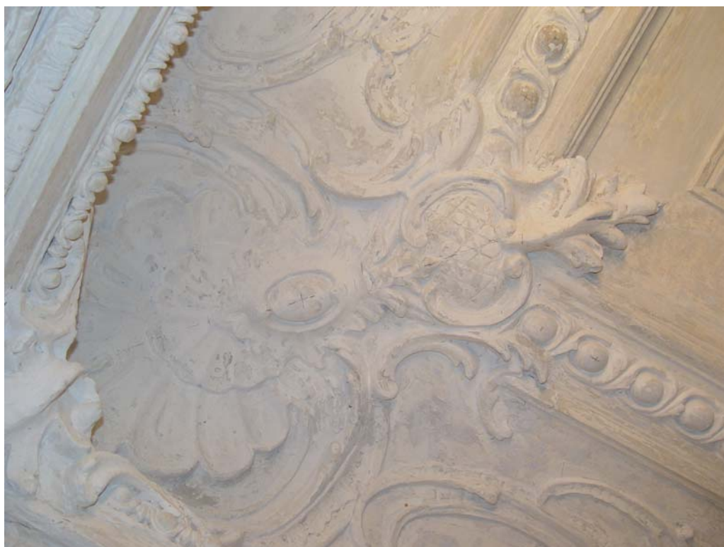
10. Дом Лобанова-Ростовского. Интерьер центрального парадного зала большой анфилады 2-го этажа (помещение 6). Оформление углов падуг. 2004 г.
