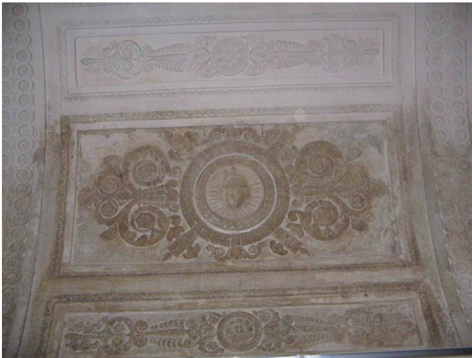
23. Дом Лобанова-Ростовского. Свод вестибюля. Повреждение лепного декора в результате переувлажнения. Апрель 2009 г.
