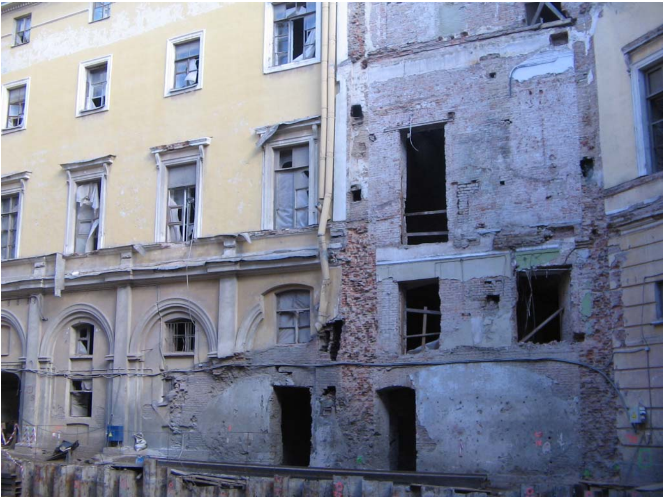
31. Дом Лобанова-Ростовского Дворовый фасад после сноса флигеля А-4. Сентябрь 2007 г.
