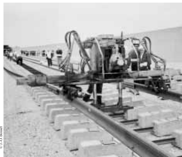
Pose des rails à l'écartement normal (provisoirement utilisés comme supports de roulement)
