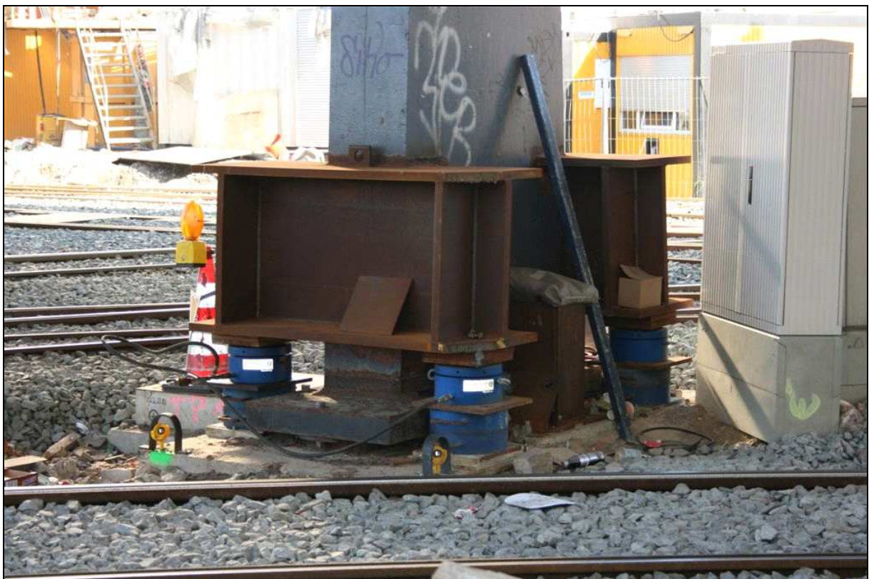
Abb. 11. Stützpfiler, darunter Neotopflager, mit Konstruktion zur Verstärkung. Foto: Dahms 9.02.2011.
