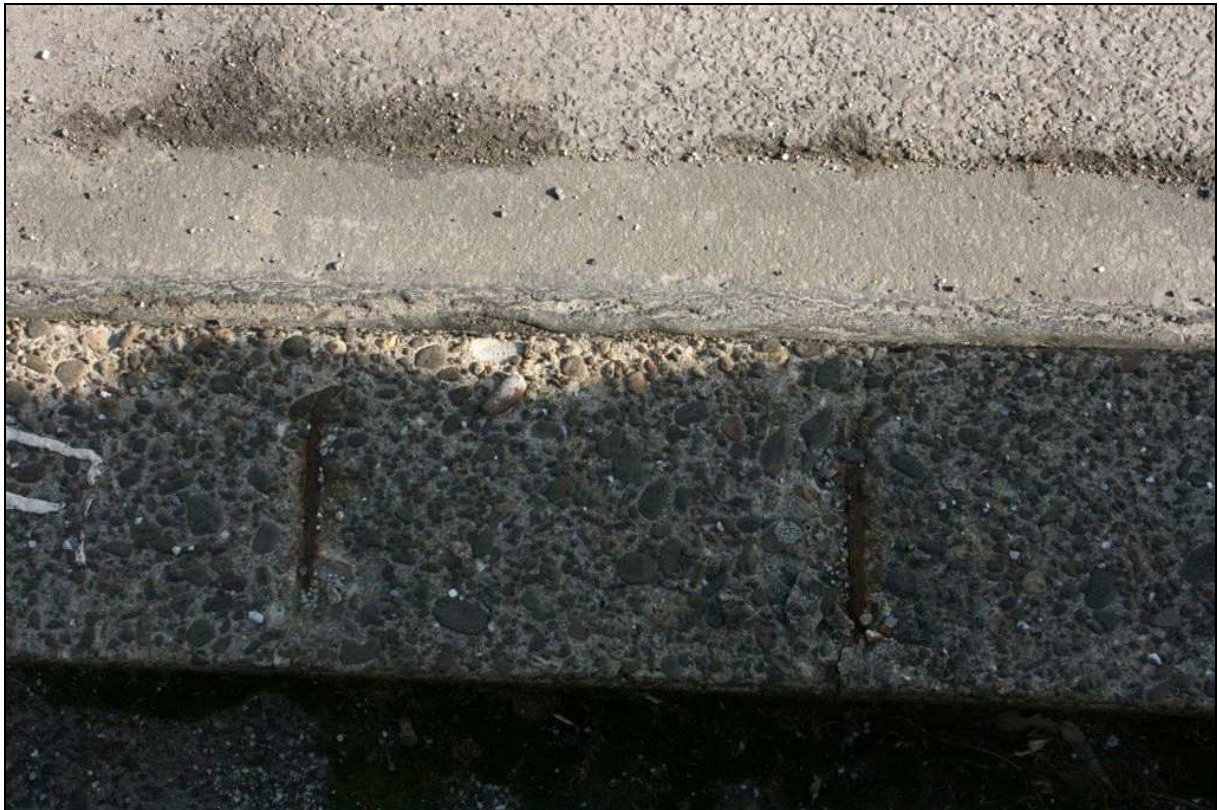
Abb. 19. Schäden an Kappen durch Korrosion auf der Hochstraße. Foto: Dahms 9.02.2011.
