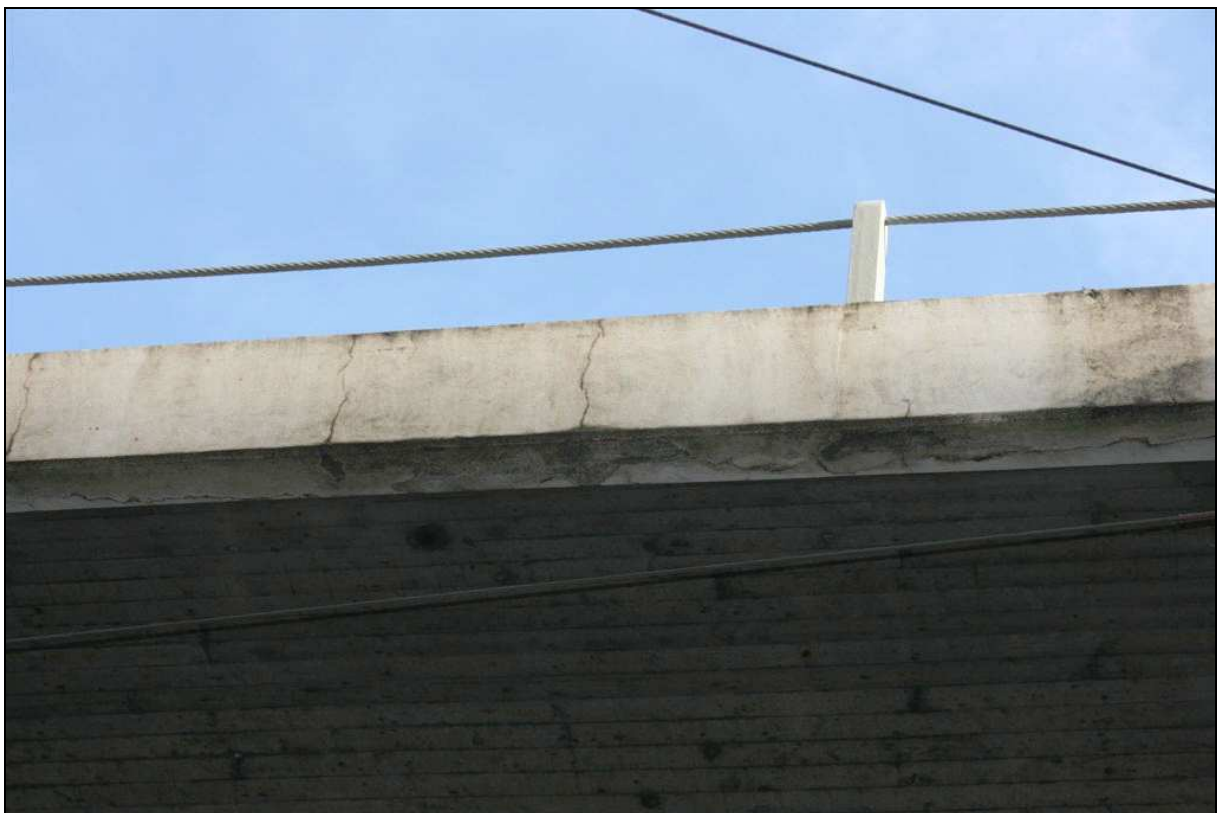
Abb. 16. Unterkonstruktion und Gesimsband der Hochstraße mit Schadensbild (Korrosion, Feuchtigkeit, Rissbildung, Abplatzungen). Foto: Dahms 9.02.2011.
