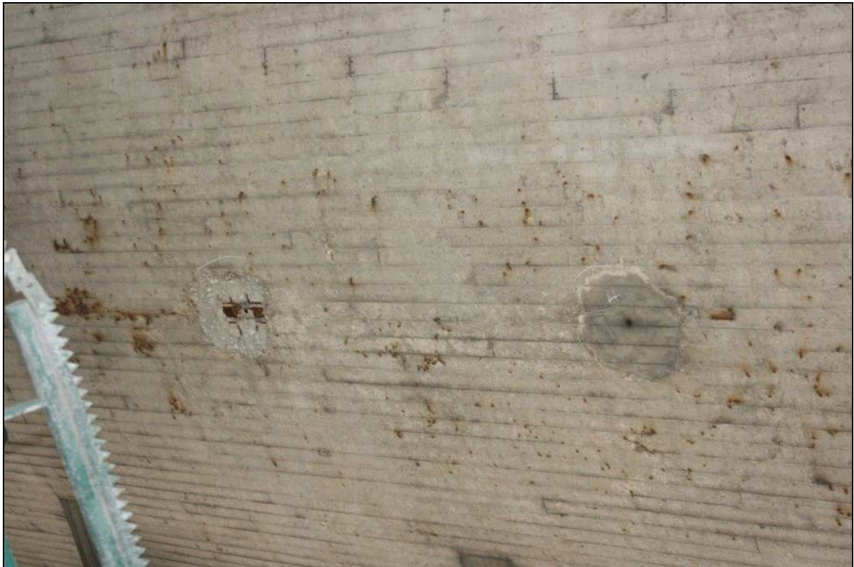
Abb. 15. Unterkonstruktion der Hochstraße mit Schadensbild (Korrosion, Abplatzungen). Foto: Dahms 9.02.2011.
