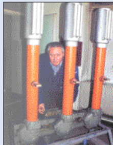
Велизар Миленковић ремонтује прекидач
