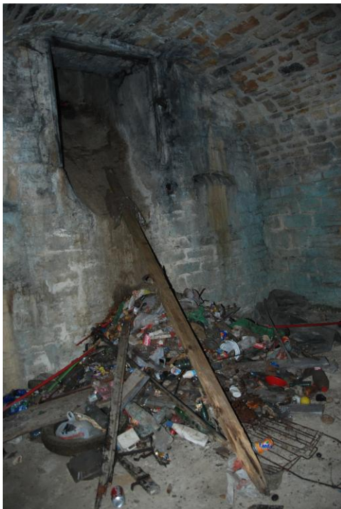
Ordures au pied d'un puits de ventilation
