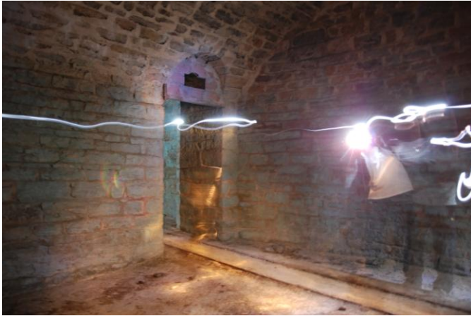
Rails de circulation pour wagonnets
