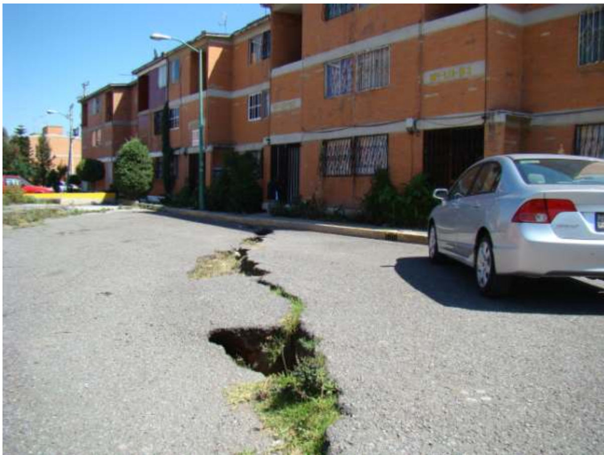
Fig. 2 Grieta típica en una zona plana
