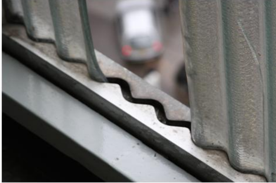
Detalle estado de ventana sector occidental edificio Bochica
