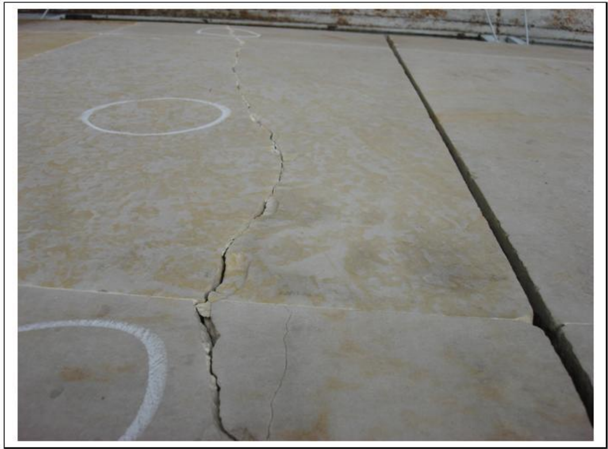
Rotura de piedras de enchape de edificaciones
