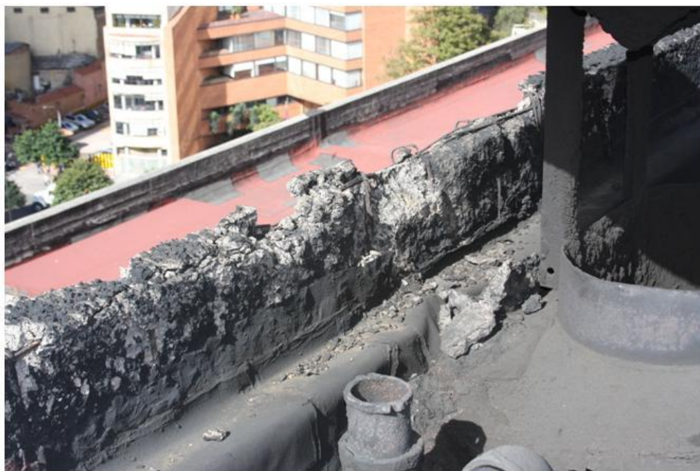
Calcinacion del concreto por presencia inadecuada de chimenea
