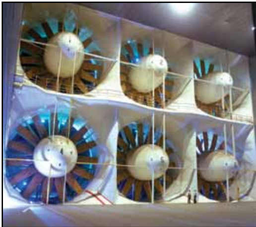
Fan Drive System
