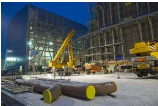
Vue nocturne - Travaux sur bâtiment principal & chaudière, façades nord-est et tuyaux en premier plan Février 2010 / PATRICK MARTIN PHOTOGRAPHE
