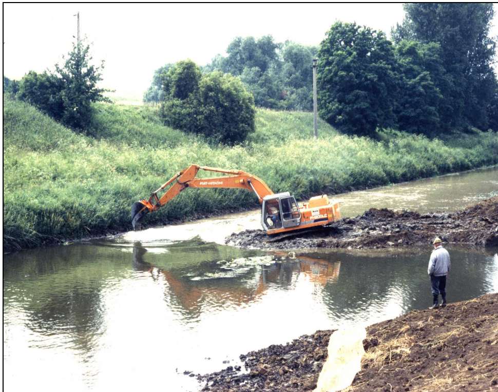
(Foto: G. Lehr ) Bild 2, Mai 1993, Bagger im Einsatz Die Steinbefestigung wurde gelöst und als inselartiges Leitwerk „recycelt“. Anschließend wurde die Nidda sich selbst überlassen. Solche Arbeiten können nur von erfahrenen Firmen durchgeführt werden.
