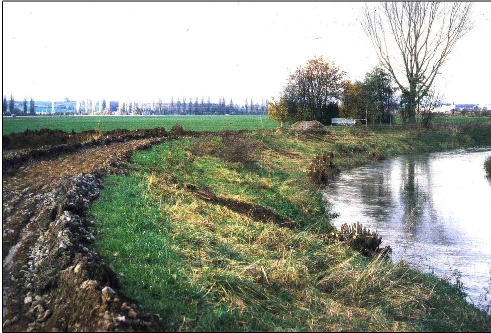
( Foto: G. Lehr ) Bild 1, November 2000 Baubeginn Nidda Knie Niddakanal mit Uferweg direkt an der Böschungsoberkante.
