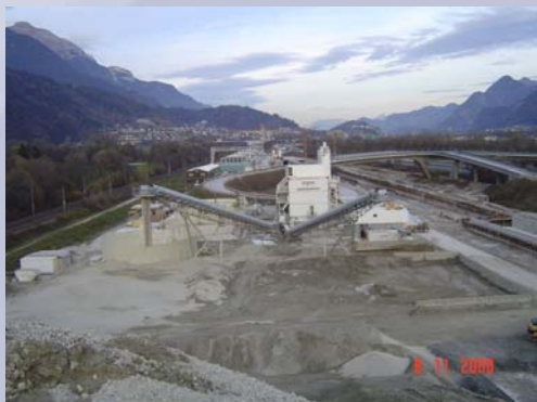
Aufbereitungsanlage Los H8
