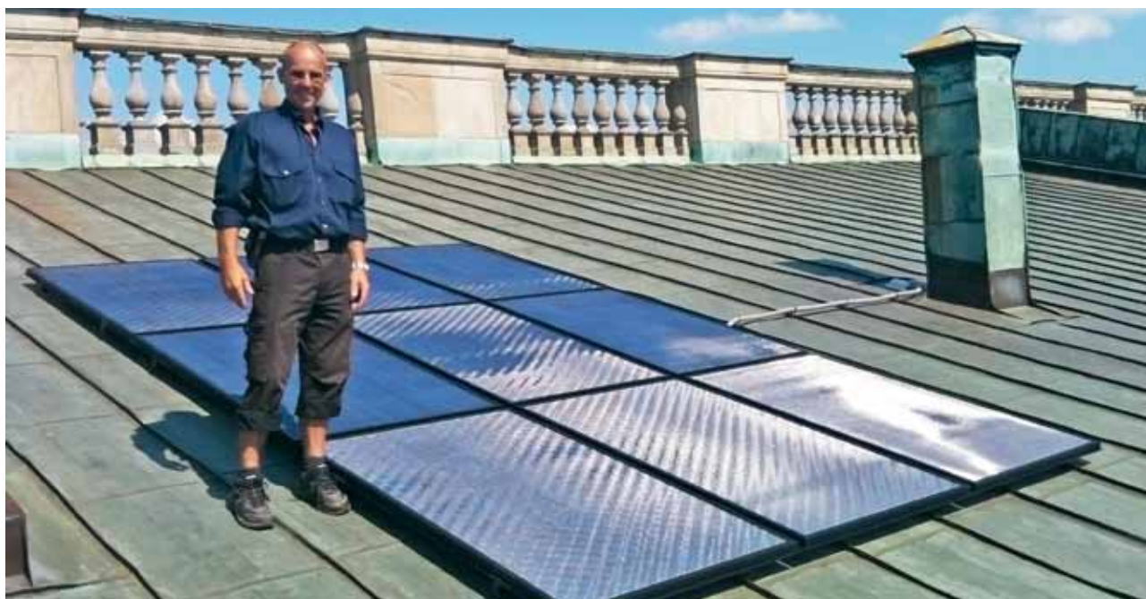
I ambitionen att finna lösningar med förnyelsebar energi, har en provanläggning med solpaneler installerats på Kungl. Slottets tak.
