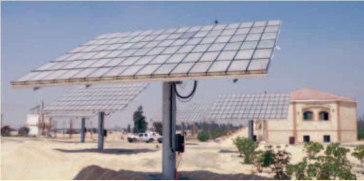
Abb. 3 Der Tracker richtet die konzentrierenden PV-Module exakt auf den Stand der Sonne aus. Im Inselsystem von Wadi Al Natroon in Ägypten versorgen sie Wasserpumpen mit elektrischer Energie, die Kommunikation erfolgt über das standardisierte CANopen Protokoll. Quelle: Fraunhofer ISE
