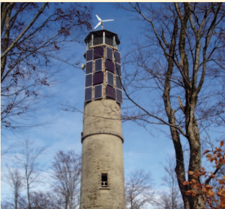
Abb. 4 Die Bündelfunkanlage für Kommunikation und Überwachung einer regionalen Eisenbahnlinie auf dem Brandeckkopfturm bei Offenburg wird mit einer PV-Hybridanlage betrieben. Quelle: Steca Elektronik GmbH
