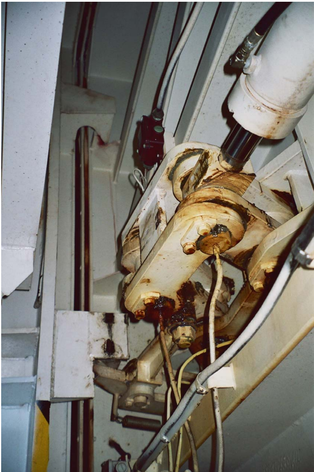
Photo 3 : Vérin en phase de déverrouillage de la porte, levier de déverrouillage en traction de la porte.
