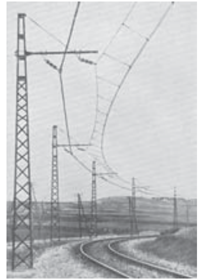
Électrification de lignes archives Spie.
