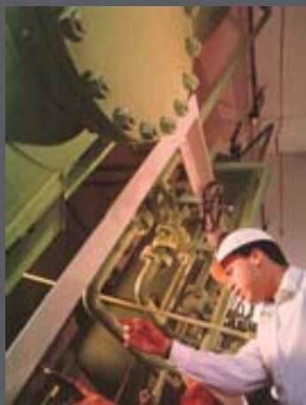
Centrale thermique Studio Pons.
