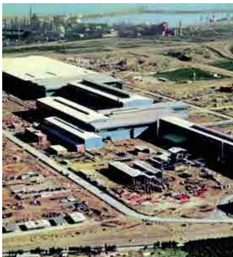
Obrascón cambió de manos en 1973. Altos Hornos de Vizcaya (AHV) la adquirió para construir la IV planta siderúrgica integral en Sagunto, cuyas obras refleja la imagen.
