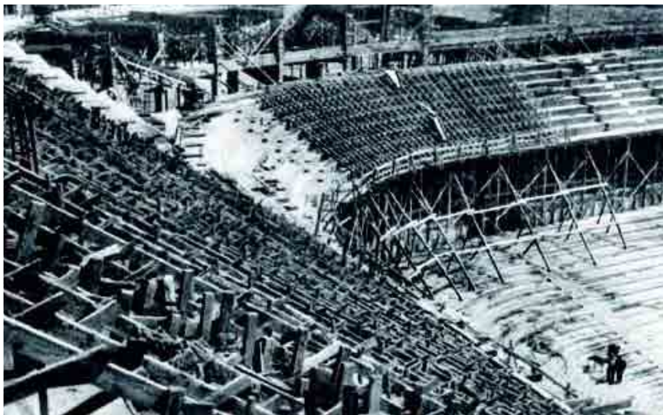
Así avanzaba la construcción por Huarte del Estadio Santiago Chamartín de la Rosa en 1945, hoy Santiago Bernabeu.
