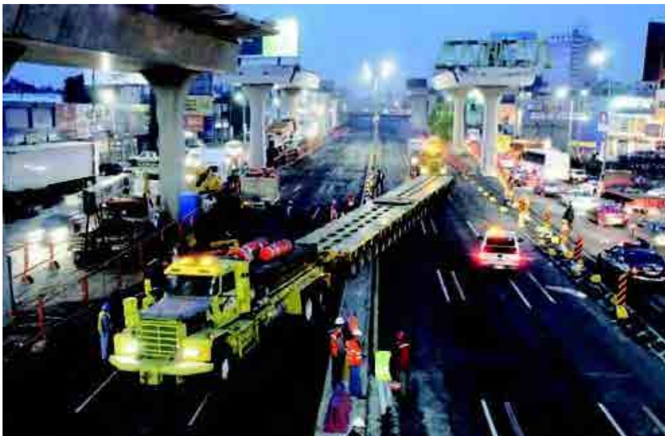
OHL desarrolla obras de gran envergadura, un buen ejemplo de las cuales es la construcción del Viaducto del Bicentenario en Ciudad de México.
