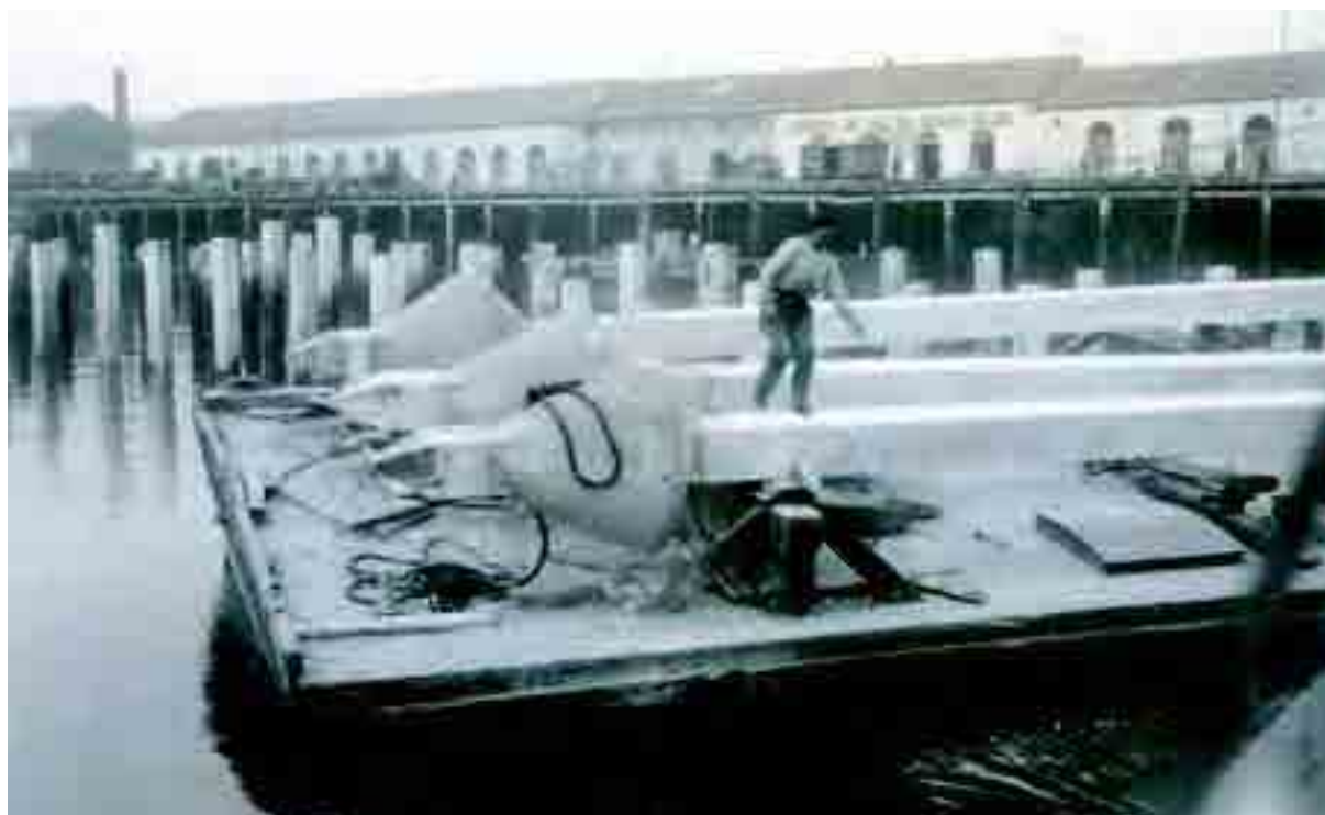
Colocación de pilotes prefabricados de hormigón en el Puerto de Santander, obra realizada por Obrascón en 1930.
