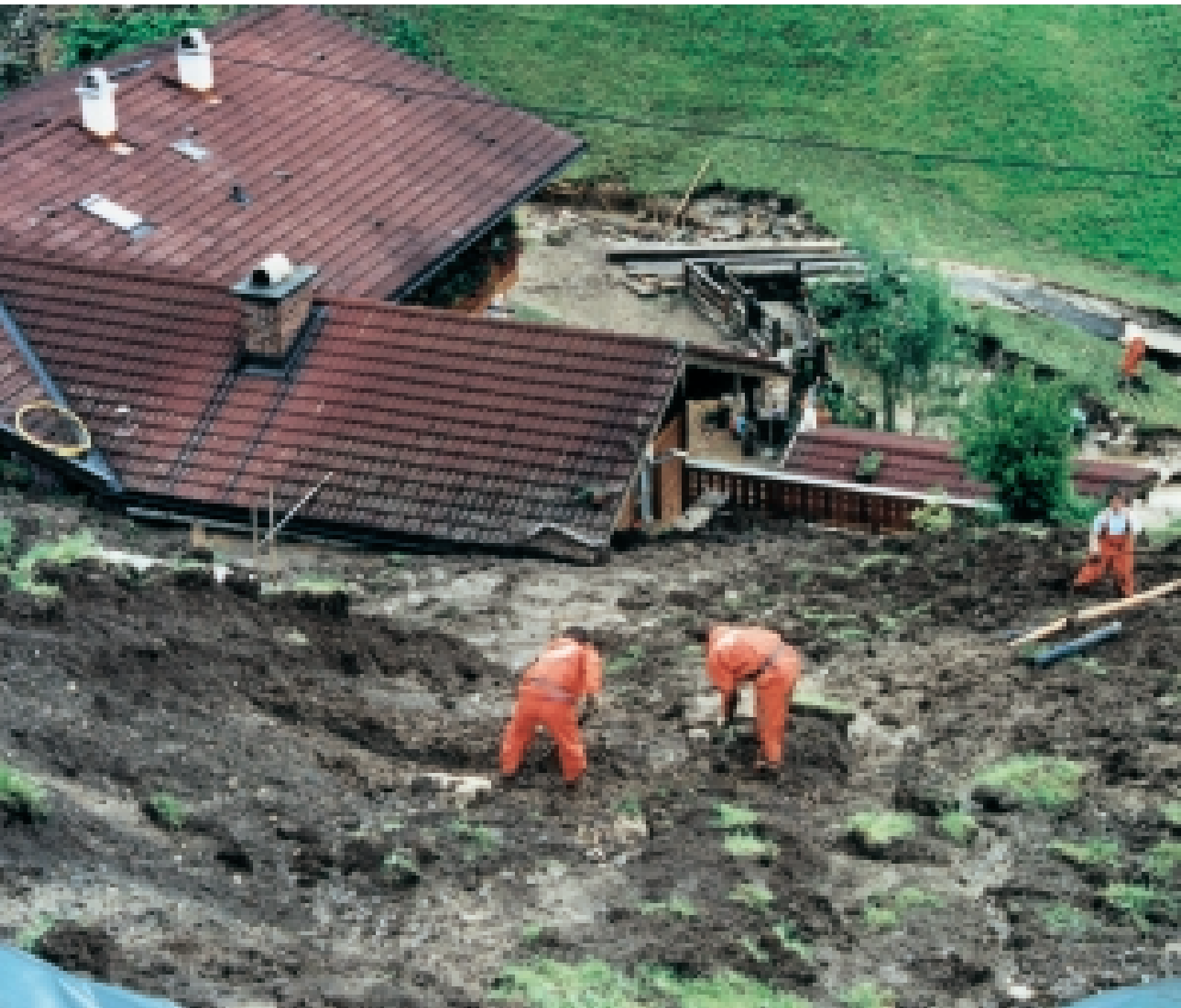
14, 15 Stürme sind in der Regel auch mit starken Regenfällen verbunden. Diese können – wie hier bei einem Unwetter in Bayern – ganze Hänge destabilisieren. Wenn bei Bauvorhaben keine Sicherheitsabstände zu rutschgefährdeten Hängen eingehalten werden, sind Schadenereignisse oft nur eine Frage der Zeit. Die Abbildungen zeigen ein verschüttetes Haus bei Berchtesgaden, das nach sintflutartigen Niederschlägen von Hangrutschen erfaßt wurde.
