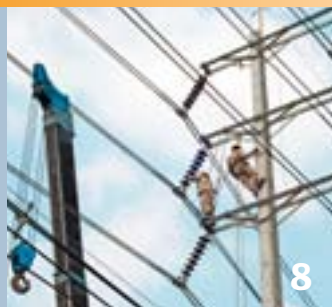
Investitionen in die Zukunft: Neue Infrastrukturen für Telekommunikation und Energie
