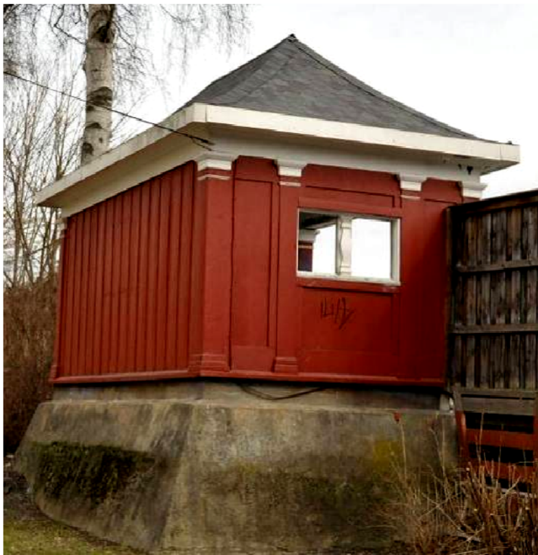
Sokkelen bærer preg av å ha blitt forhøyet og er senere pusset. Foto: Byantikvaren/Høvås 2010
