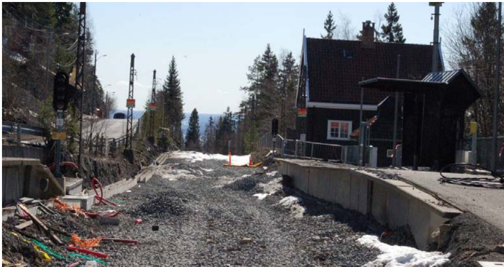
Omlegging til metrostandard i 2010 krever inngrep i banelegemet. Stasjonsbygningen og privét tegnet av Erik Glosimodt skal bevares. A. Henriksens leskur har ikke erkjent verneverdi her. Foto: Byantikvaren/Høvås 2010
