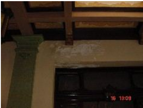
Foto 20. Muro en corredor. Humedad
