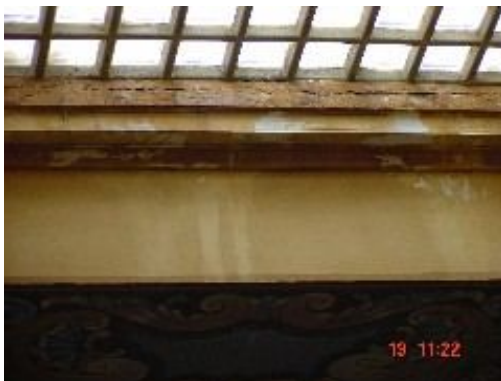
Foto 23. Lucernario. Muestra humedad.
