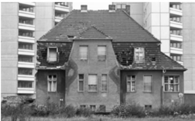
Da die Regierung vornehmlich in den Wohnungsneubau investiert, sind städtische Altbauten über einen langen Zeitraum dem Verfall preisgegeben. Haus in Berlin-Marzahn 1987
